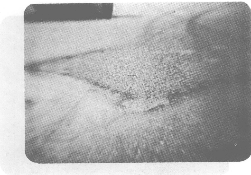
شکل ۷ - خرابی موضعی (باند اصلی ۲۹ چپ) سوختگی قیر سطح آسفالت
