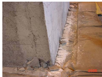
الف) ترک طولی شناژ قائم
